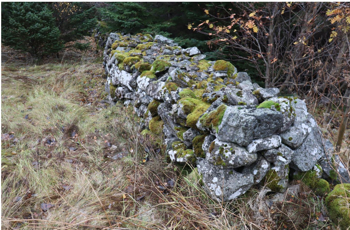
Mynd 11. Hluti garðlags sem er stendur hátt. Snið veggjarins sem sést hér til hægri var teiknað.
